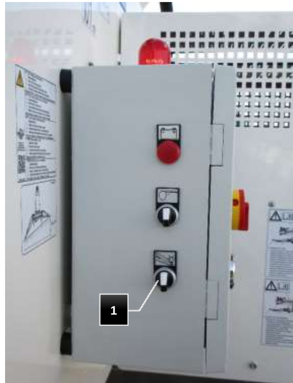
Kuva 99: Vilkkuvalojen kytkin ohjauskaapissa
